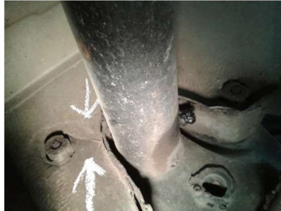
Trinca de longarina próximo à fixação do eixo.
