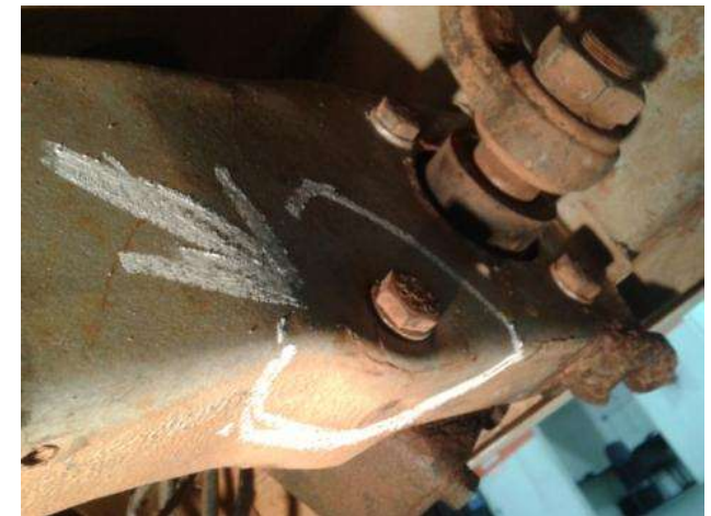
Trinca na fixação do setor de direção.
