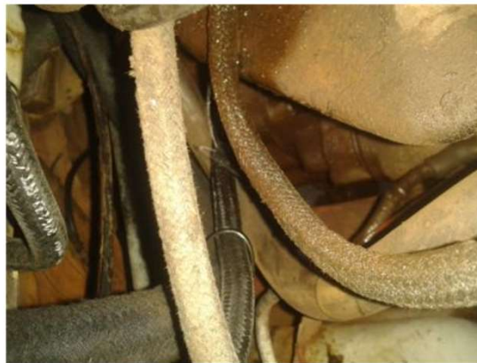
Vazamento de combustível na tubulação de alimentação.
