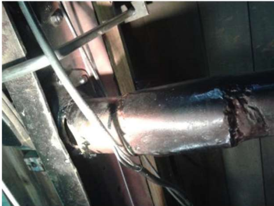
Reparo inadequado em travessa de caminhão.
