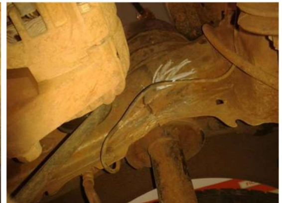
Trinca na longarina.
