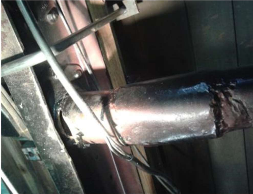
Reparo inadequado em travessa de caminhão.
